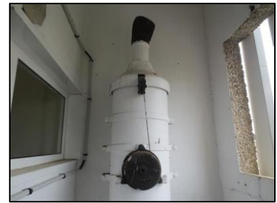
Photo N° 711 AMIANTE CIMENT 14 BLAISE--LOCAL V.O RDC à +4 Vide-ordures Gaine V.O.(Fibres-ciment)
